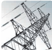
Анкерно-угловые опоры ЛЭП
